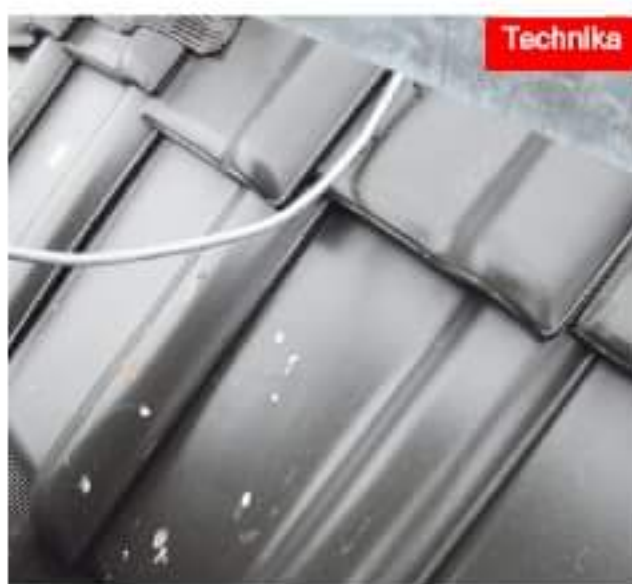
Prace remontowe przyczyną potencjalnych utrudnień eksploatacyjnych. Błędy wykonawcze pokrycia dachu
